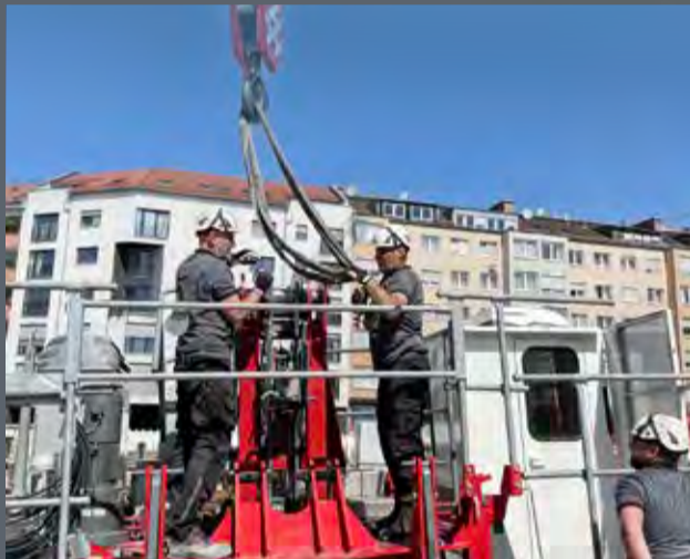
Beutlhauser-Monteure haben den neuen Kran aufgebaut. Dieser wurde anschließend genutzt, um einen weiteren Kran zu montieren.
