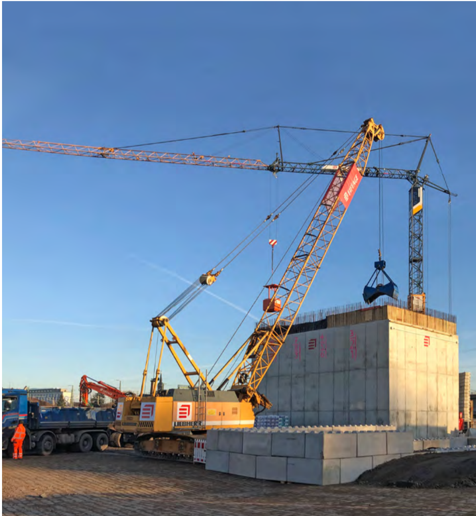
Für diese Aufgabe wurde der Liebherr Seilbagger HS 853 mit einem Kamerasystem sowie einer Seillängenmessung ausgestattet.
